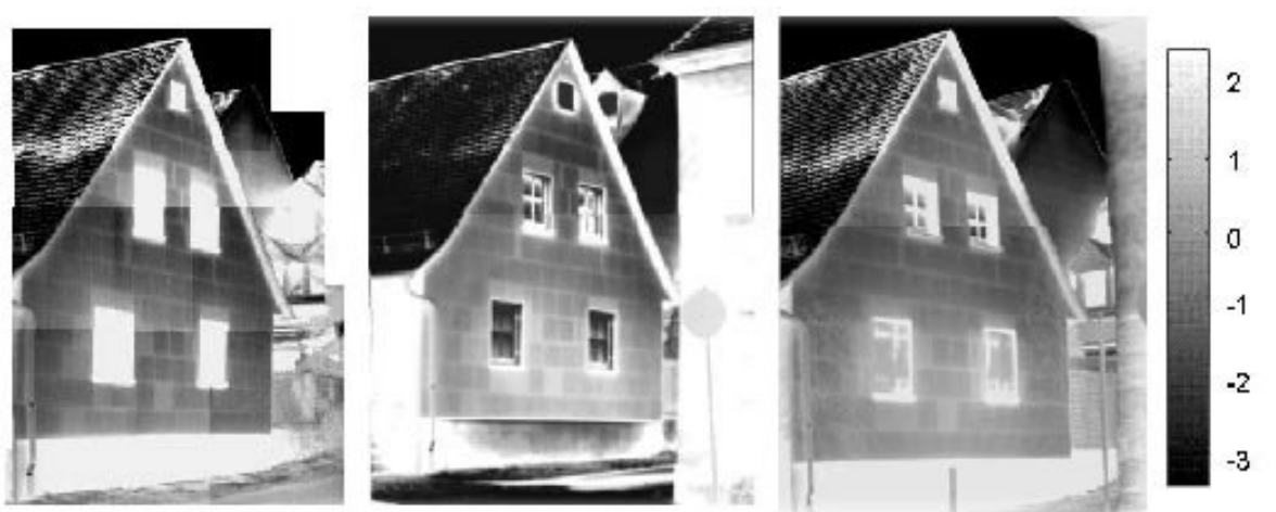
Abbildung 5: IR-Aufnahmen der Giebelfassade unmittelbar nach der Sanierung (links: 2001), nach einem Jahr (mitte: 2002) und nach zwei Jahren (rechts: 2003).
