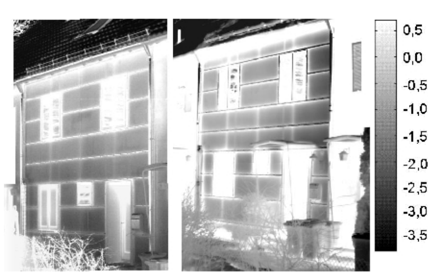
Abbildung 20: IR-Aufnahme nach unmittelbar nach Einbau der VIPs (links: 2002) und nach einem Jahr (rechts: 2003).
