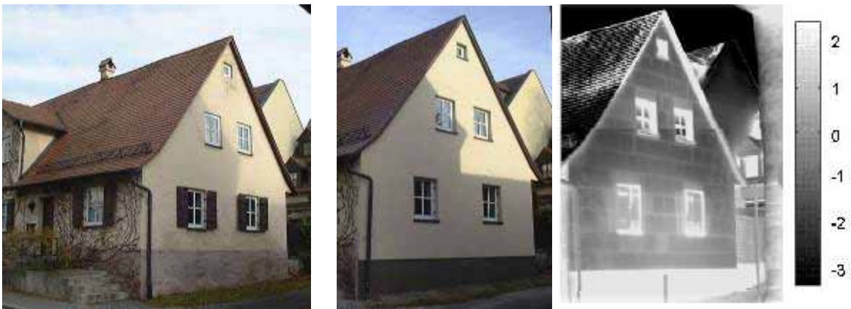
Abbildung 37: Aufnahmen der Giebelwand vor (links) und nach (mitte) der Dämmung. Die IR-Aufnahme (von 2003) zeigt die Grenzen zwischen den VIP als helle Streifen (Wärmebrücken) genauso wie Passstücke aus Polystyrol (z.B. im Bereich der Fensterstürze).
