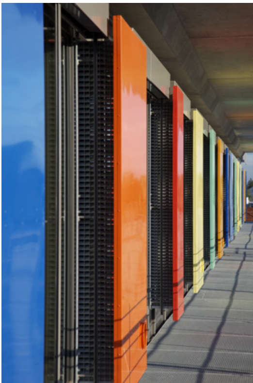
Verblendungen der Lüftungklappen
