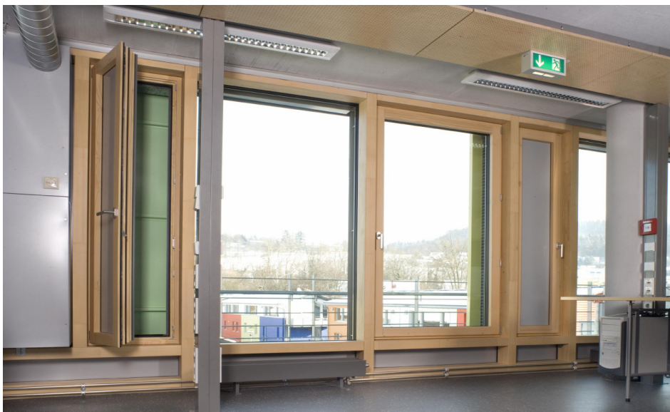
Einsatz von dreifachverglasten Fenstern und VIP im Sonnenschiff
