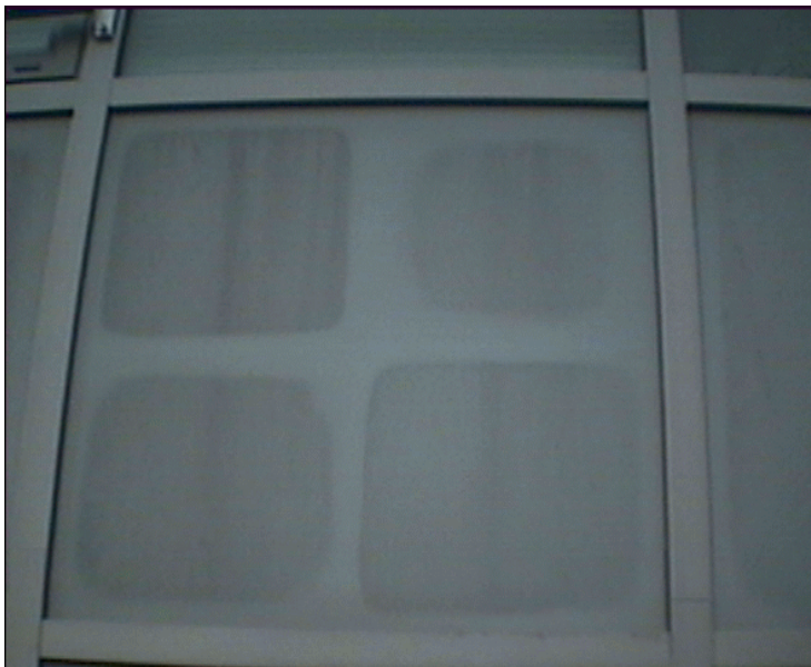
Kondensatbildung erfolgt nicht über den wärmeren Stößen
